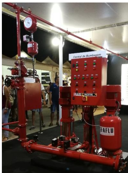
Figura 12. Central de Bombagem (em exposição na feira Fatacil, Lagos, Portugal, agosto 2017)
