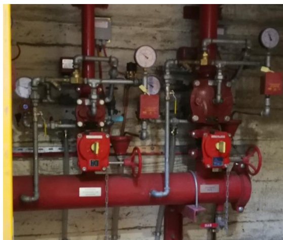
Figura 13. Sistema Automático de Extinção de Incêndios da Instalação de CDR's
