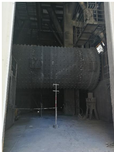
Figura 26. Instalação de Moagem de Combustíveis Sólidos, no CPA
