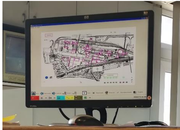
Figura 16. Sistema de Controlo e Deteção de Incêndio do CPA
